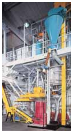
La planta piloto de KAHL: dosificador, mezclador continuo, reactor hidrotérmico, expander de abertura anular, extrusor OEE, prensa granuladora de matriz plana, secador/enfriador de cinta, Rotospray, desmigajador, molino quebrantador de rodillos
