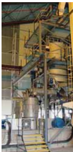
Planta granuladora para biomasa en Sudáfrica
